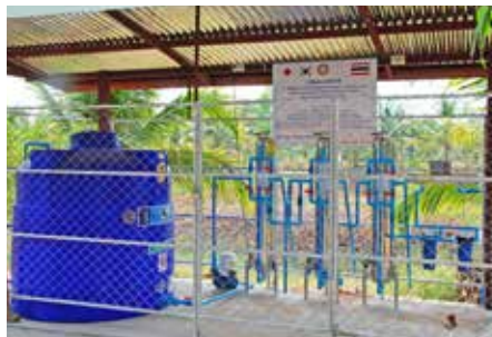
青いパイプの先に浄水器が設置されています (2010年MG事業)
